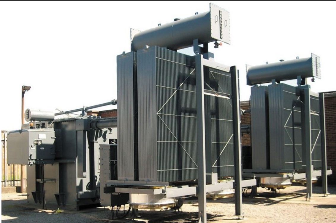
Slika 2.7 Odvojeni sustav za hlađenje transformatora 3 [6]
