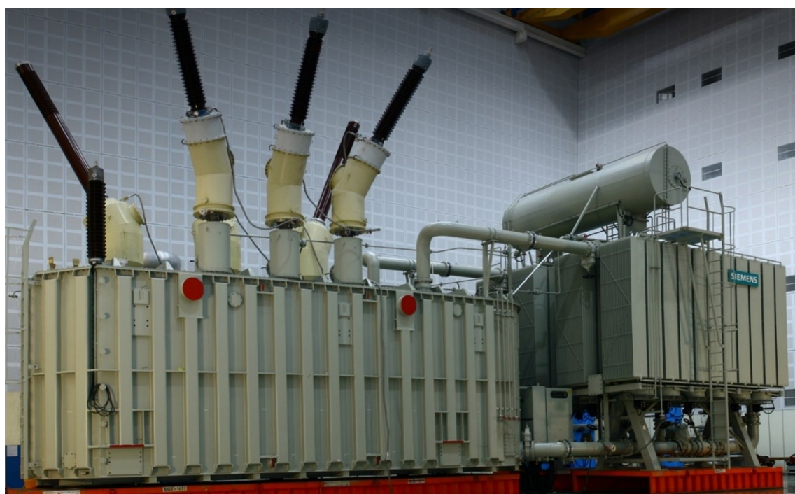
Slika 2.8 Odvojeni sustav za hlađenje transformatora 4 [7]
