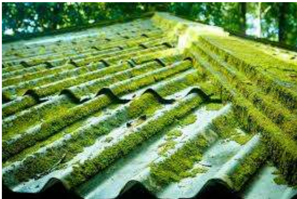
Slika 9. Mahovina na limenom krovu [6]
